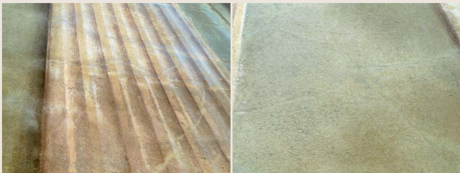
Fotografie scattate dopo 7 anni dall'intervento. Le fessurazioni integrate hanno retto bene alla prova del tempo pur nelle condizioni particolarmente critiche cui è esposta questa facciata: la chiesa è prospiciente al mare, quindi sottoposta ad aerosol marino.
